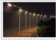
街道、隧道照明
