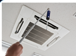
空调出风口测试
