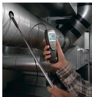
监测通风管道的风速
