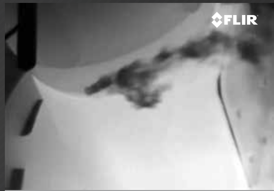
检测R-124压缩机泄漏
