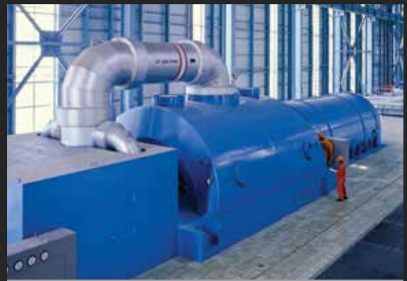
检测来自氢冷发电机的泄漏
