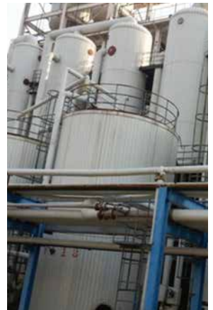
垃圾渗滤液 浓缩结晶
