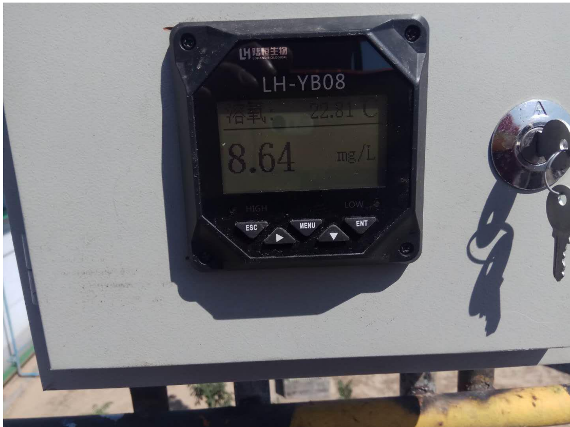
②河南某污水厂安装：在线溶解氧检测仪（荧光法，沉入式）
