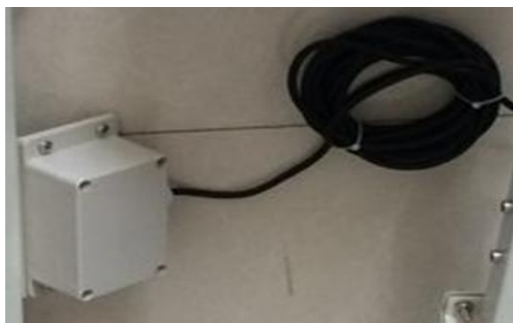
(风速风向变送器正面)
