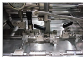
Back flushing system 逆流清洗系统
