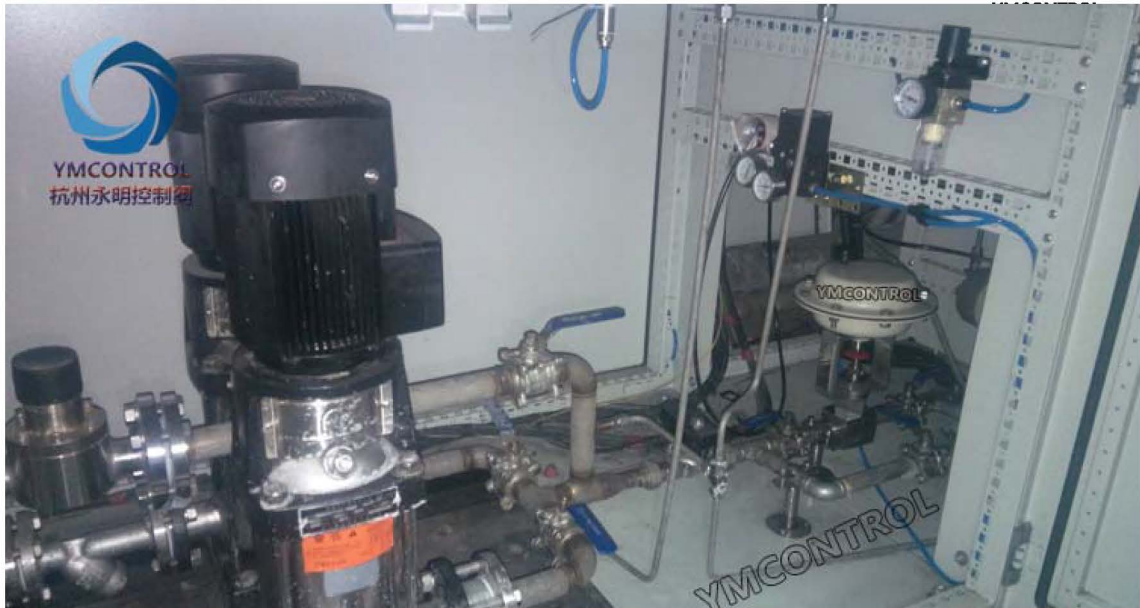
上图：SNCR 脱硝工况·氨水微小流量调节阀
