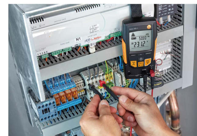
测量热泵开关盒中的电压
