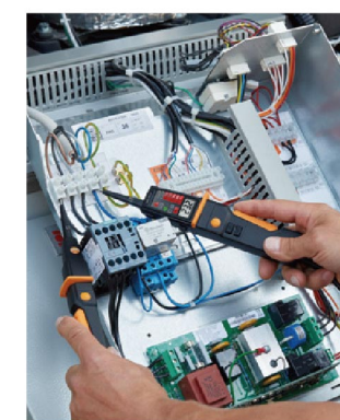
测量压缩机电压
