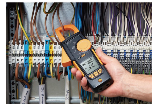
测量开关柜电流
