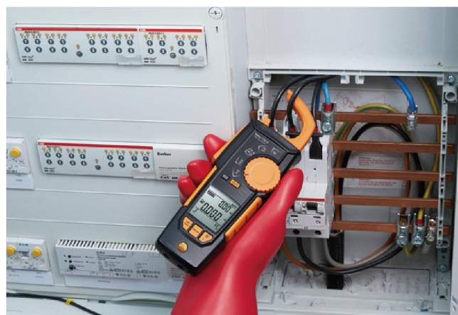
测量开关柜电流
