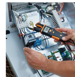
测量压缩机电压
