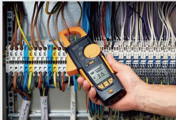
测量开关柜电流
