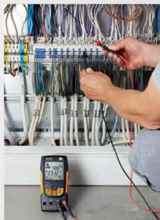
测量开关柜中的电压
