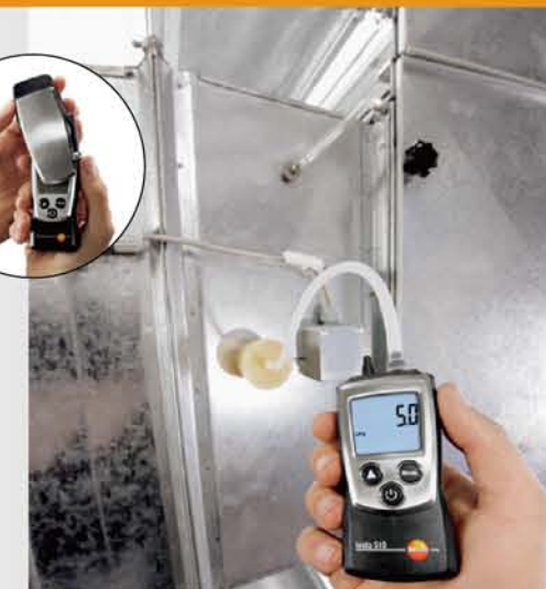
测量过滤器的差压
