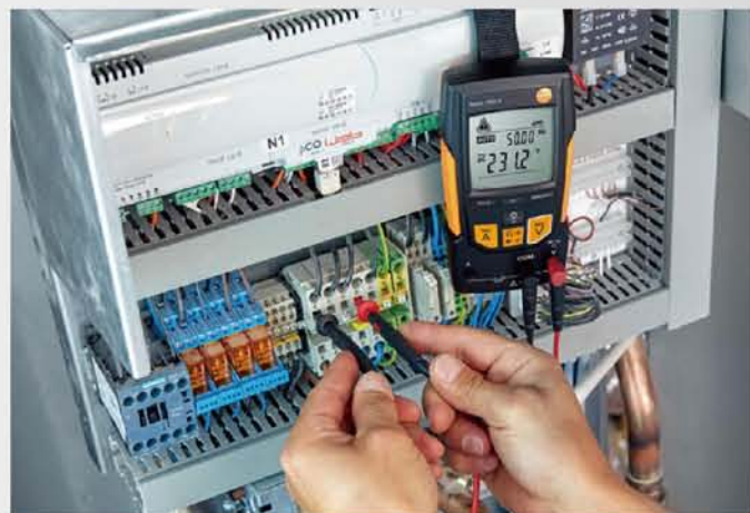
测量热泵开关盒中的电压
