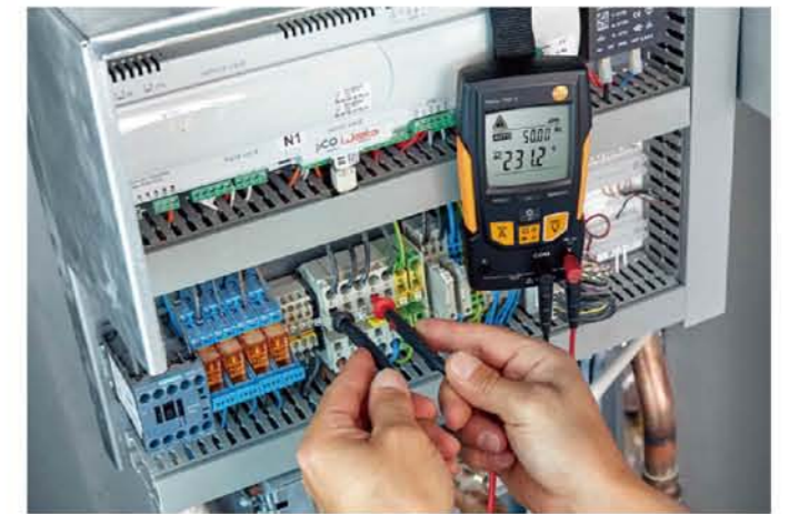
测量热泵开关盒中的电压
