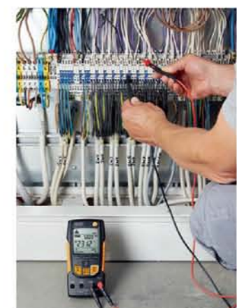
测量开关柜中的电压
