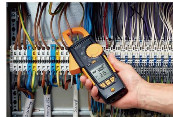
测量开关柜电流
