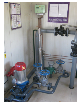
系统安装于采油井站计量间内
