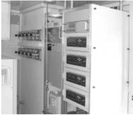
安装在南非某集成系统
