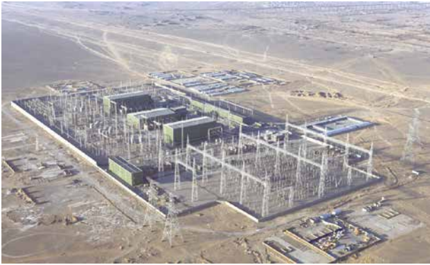
特高压直流输电换流站
