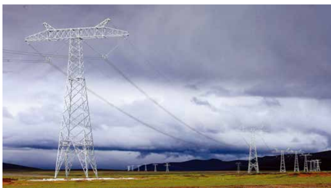
青海柴达木-西藏拉萨±400kV直流输电线路
