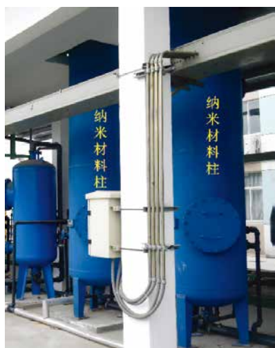
纳米复合材料应用工程装置
