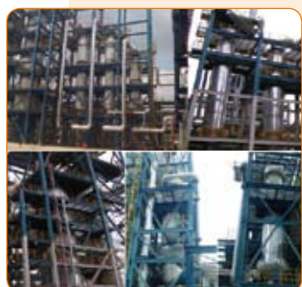
加氢裂化装置高温缠绕管式换热器应用现场
