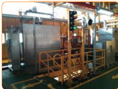
生活污水处理装置
