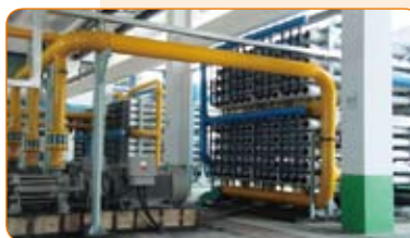
舟山六横海水淡化单机装置
